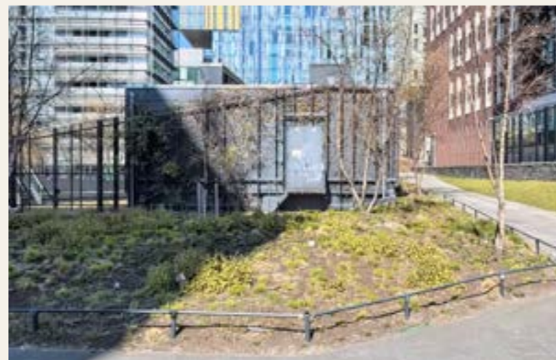
3.46 Zuiderspoorstraat Rotterdam onderstation met groene gevel.
